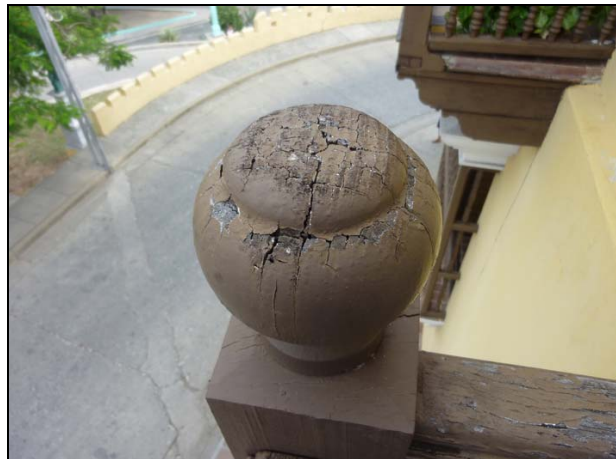
Pomo decorativo agrietado y cuarteado
