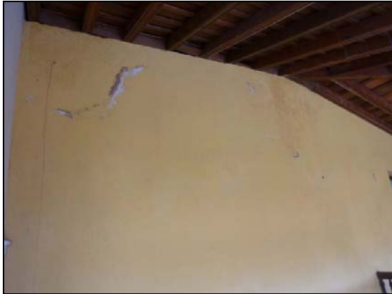
Desprendimientos de pintura mancha humedad a la altura de la cumbreira
