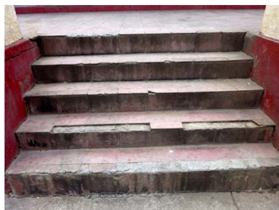
Desprendimiento de piezas escalera
