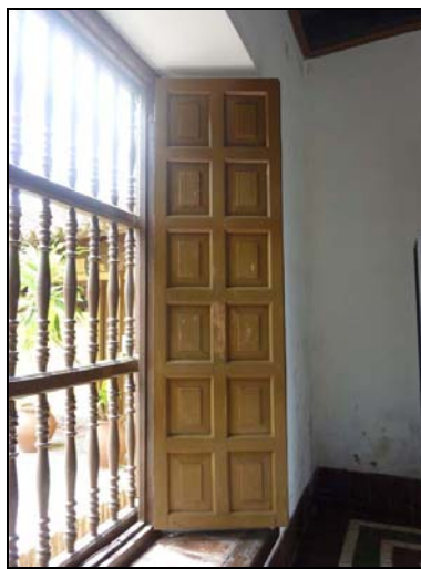
Desconchados y decoloración de la carpintería
