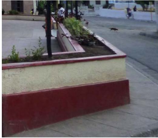
Suciedad de murete
