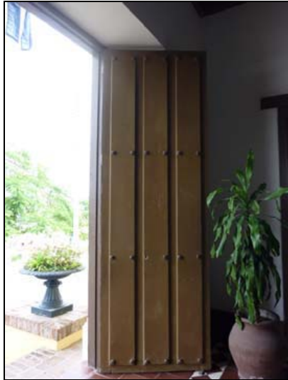
Desconchados y decoloración de la puerta principal
