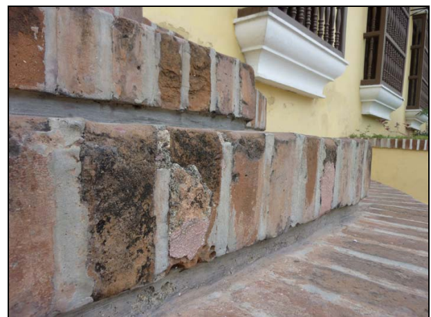
Peldaños, erosionados y desgastados
