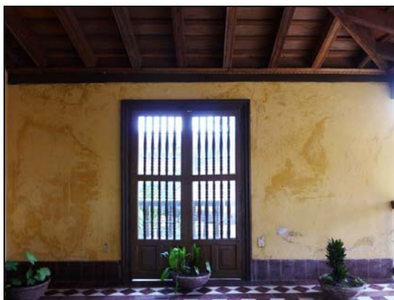
Manchas de humedad en la totalidad del muro este
