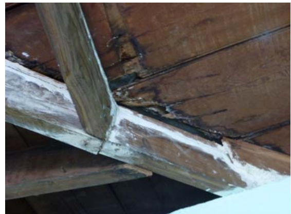
Detalle de pudrición en viga
