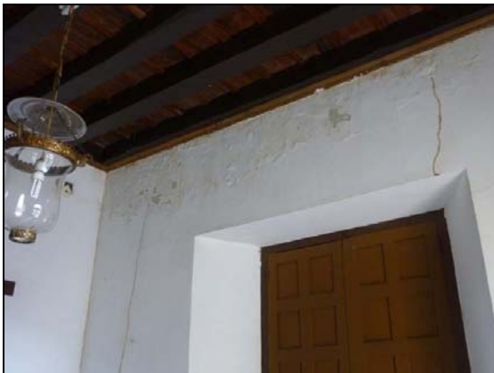
Humedad por filtración proveniente de cubierta Presencia de abolsamientos y desconchados
