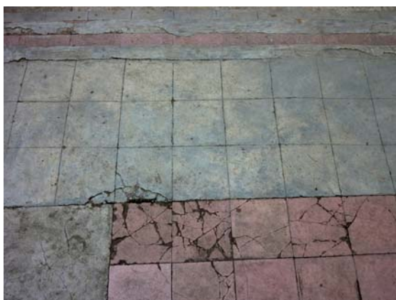
Rotura pavimento zona cielo abierto
