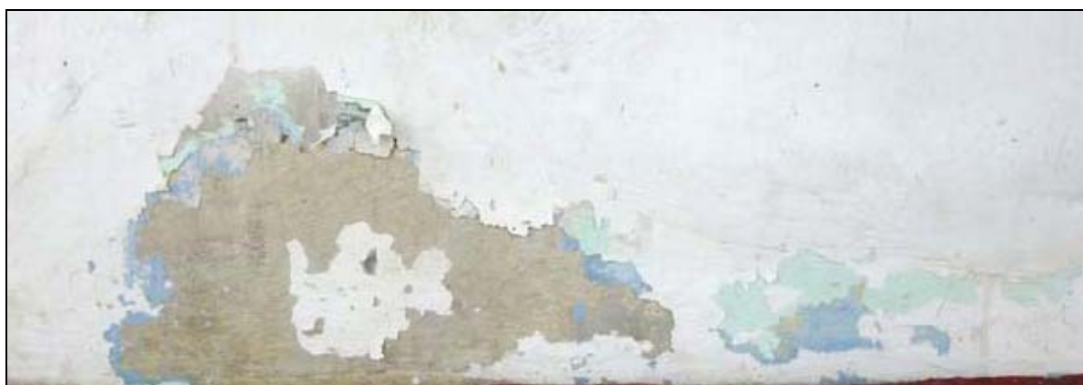
Desconchados_ distintas capas de pintura
