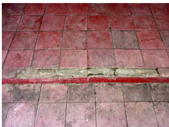
Desprendimiento de piezas
