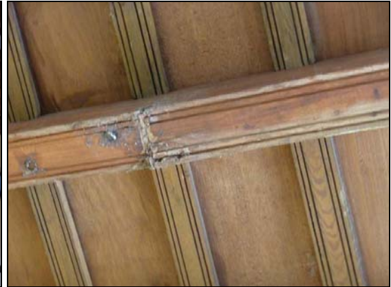
Pudrición en viga, aparición de grieta transversal
