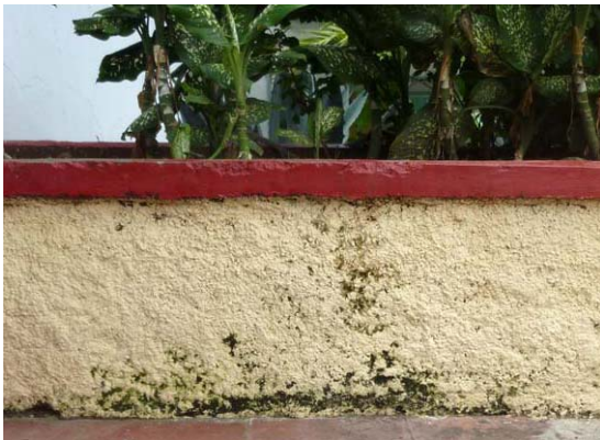
Manchas de moho o musgo en murete
