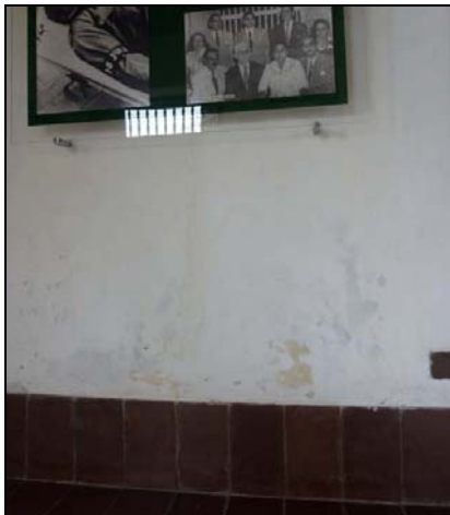
Humedades por capilaridad en muro
