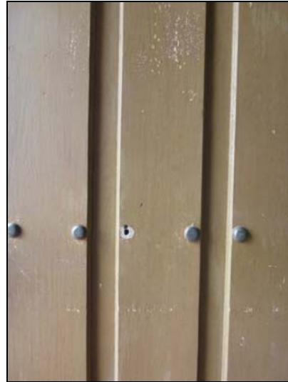
Falta de clavos
