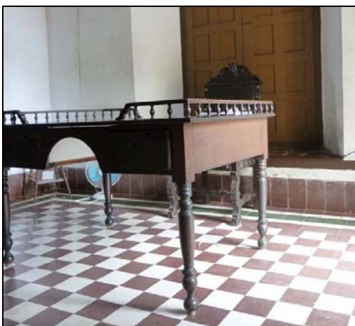
Humedad por capilaridad en muro y pollo puerta
