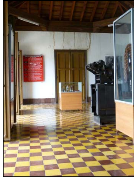
Muros fachada este, grandes manchas de humedad y regueros de comején
