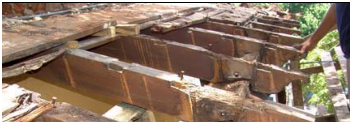
Fotografía de la cubierta, una vez desmontadas las tejas, Se aprecia la pudrición de la madera. 2006
