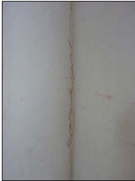
Fisura entre fachada y pared medianera con salón técnico
