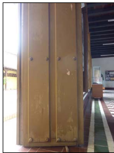
Puerta de Salida al patio, humedad en zona baja decoloración y desconchados
