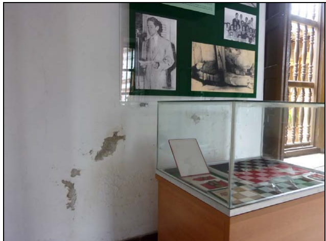
Desconchados en el muro
