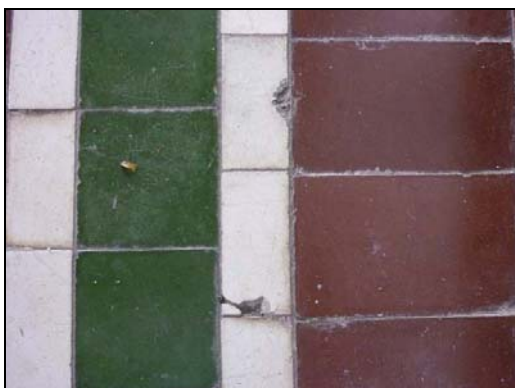
Pequeños descendimiento y roturas en pavimento
