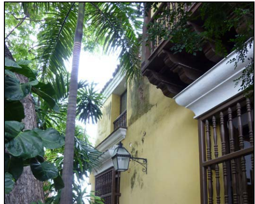
Vista exterior del muro. Grandes manchas de humedad y aparición de moho.
