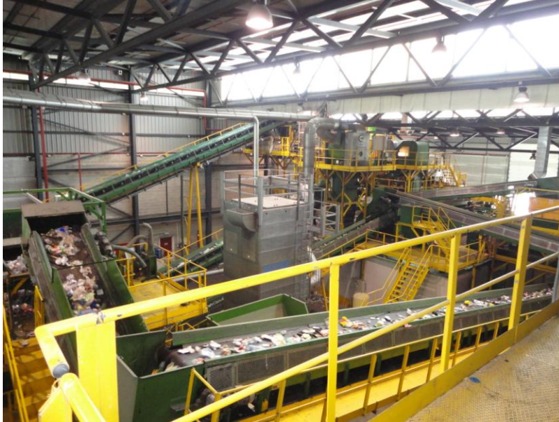
Vista interior de la planta
