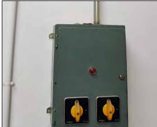
Figura 104 Armario de protecciones
