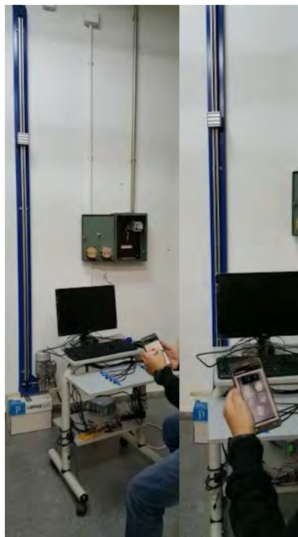
Figura 114 Control automático y manual en la Unidad Lineal
