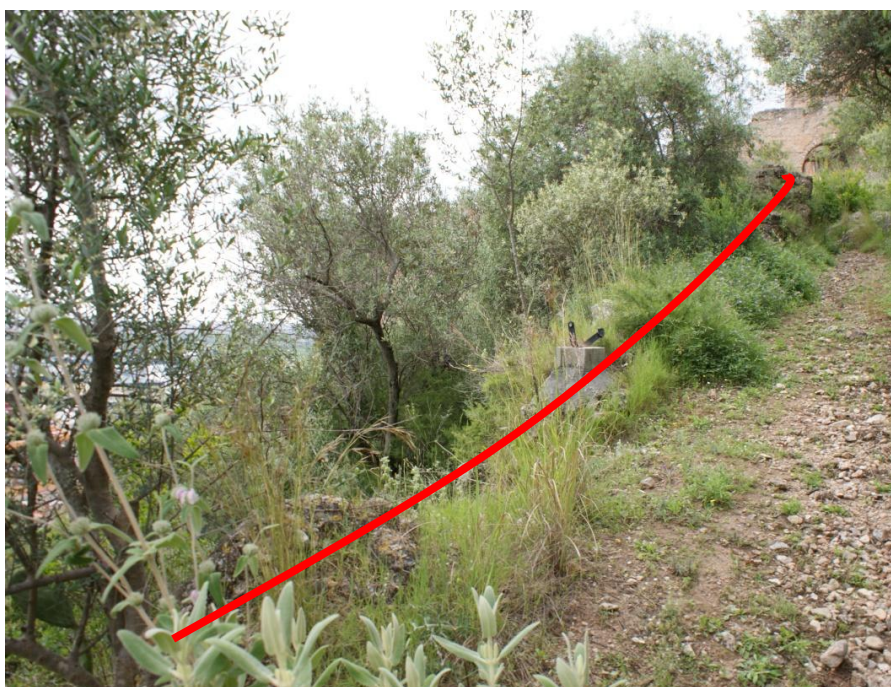
Fotografía 48. Eje del muro, uniendo los dos tramos que quedan en pie
