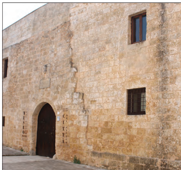
Detalle de la discontinuidad de la fábrica
