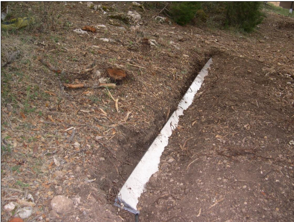
Figura 6- Canaletas de aluminio (UPV, 2018).
