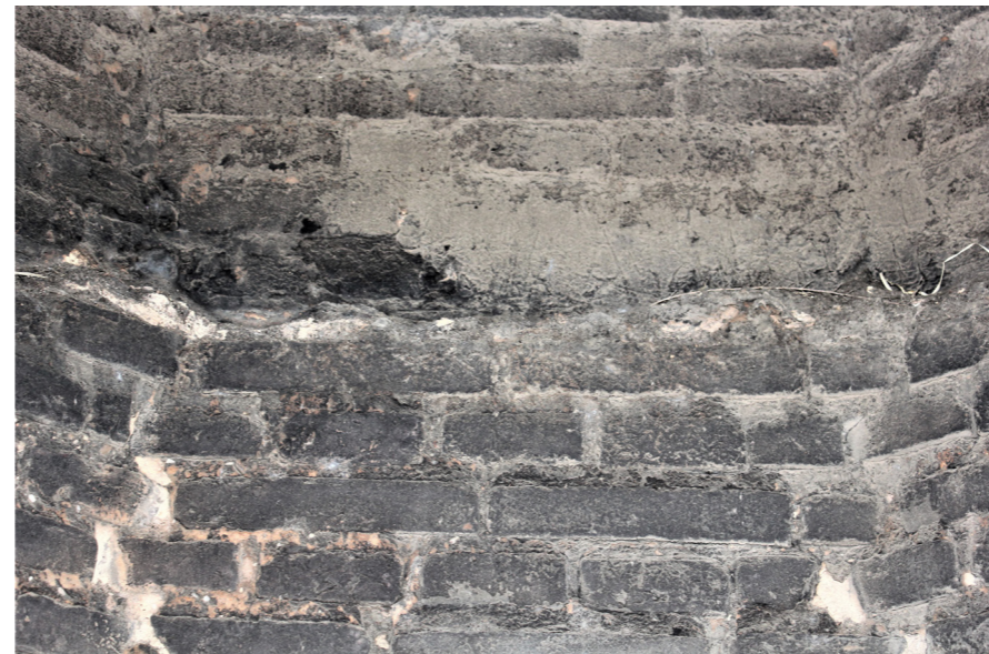
Fig. 10.99 y 10.100 (Izquierda) Vistas de la sección de la chimenea a la altura de la base. Corresponde al acceso.
