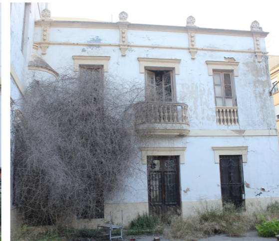
Fig. 11.24 y 11.25 Abundante vegetación en los paramentos de la fachada principal del inmueble.
