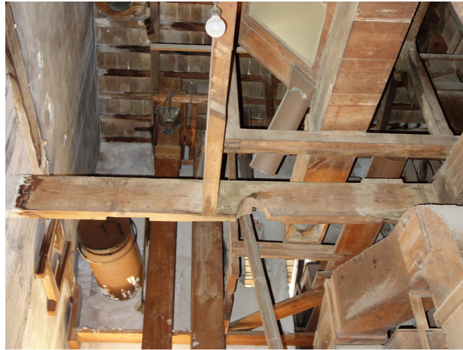
Fig. 7.3 (Izquierda) Vista general sala de maquinaria de planta baja del edificio de molino.
