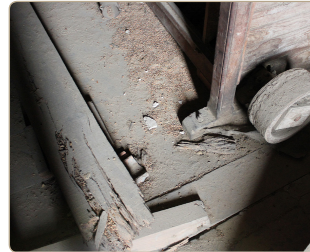
Fig. 10.34 (Arriba) Vista de zona del forjado, hay un listón colocado para el paso, de manera perpendicular a los listones de forjado debido al mal estado de estos.
