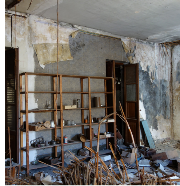
Fig. 11.12 (Izquierda) Fallo de forjado de planta 1º de nave lateral derecha debido a la filtración de agua a través de cubierta y muro.
