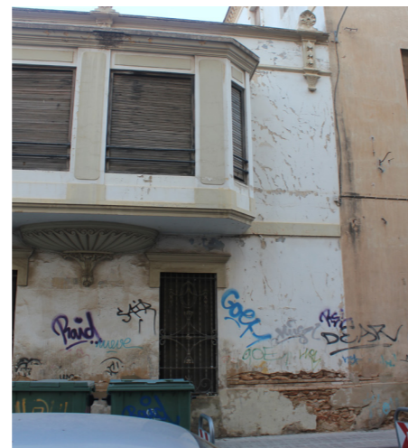
Fig. 11.30 y 11.31 Presencia de graffitis en todo el paramento de fachada este hasta una altura en algunos casos de 2,5 m.
