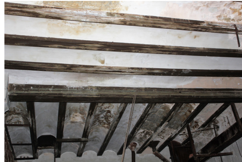
Fig. 11.22 (Izquierda) Pudrición en las cabezas de las correas de la cubierta de la 2º planta del molino.
