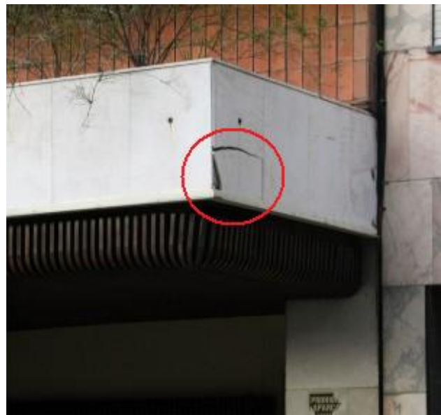
Rotura de pieza en esquina de voladizo
