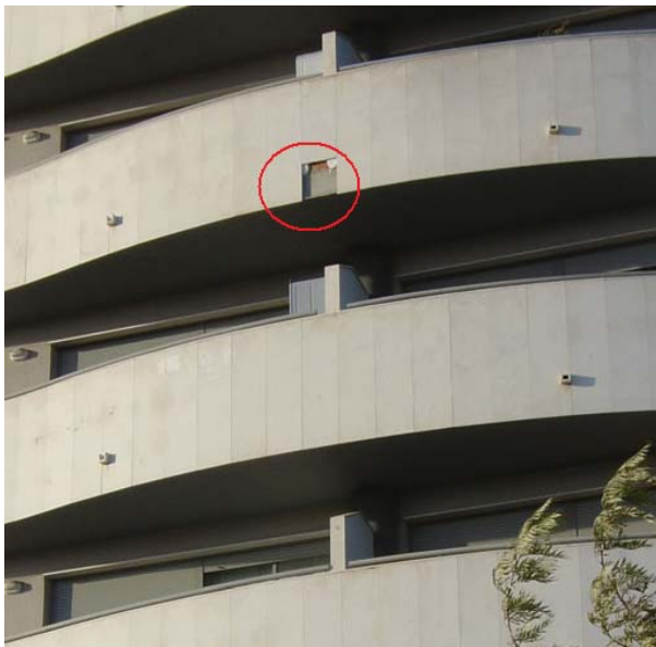
Desprendimiento de placa
