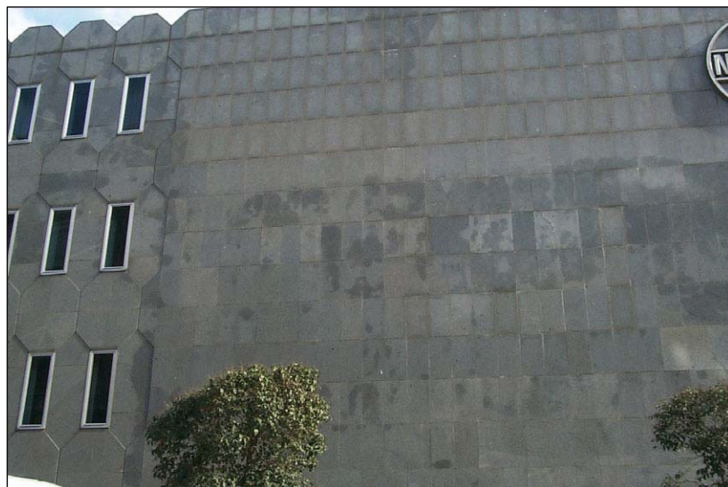
Fachada ventilada con problemas de humedades
