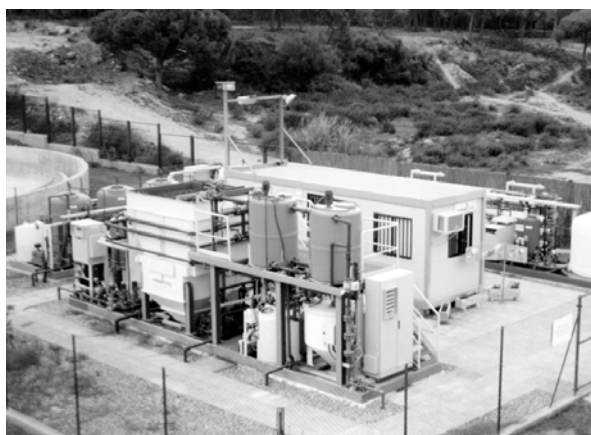
Figura 1: Vista general de la instalación experimental.
