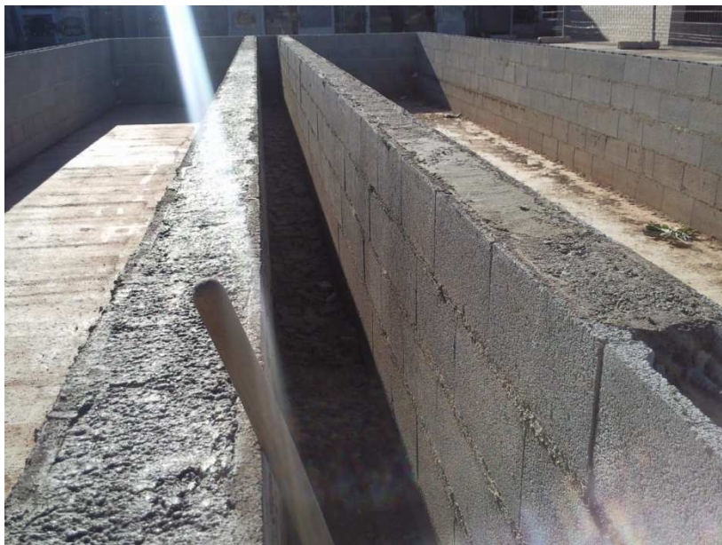
Cámara de ventilación y extracción de lixiviados
