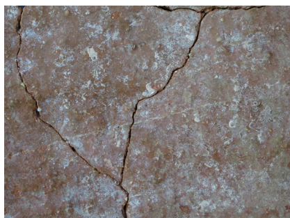
Figura 7. Detalle del acabado de la superficie interna. Se aprecia abrasión significativa del vidriado y pérdida parcial de brillo.
