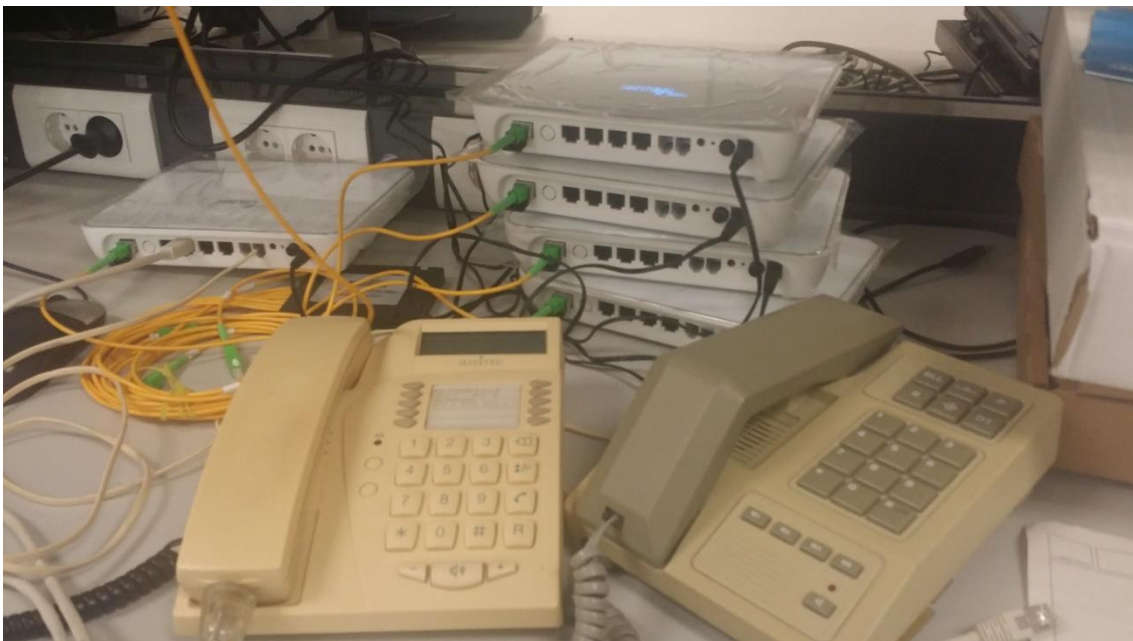
Figura 23. ONT y teléfonos
