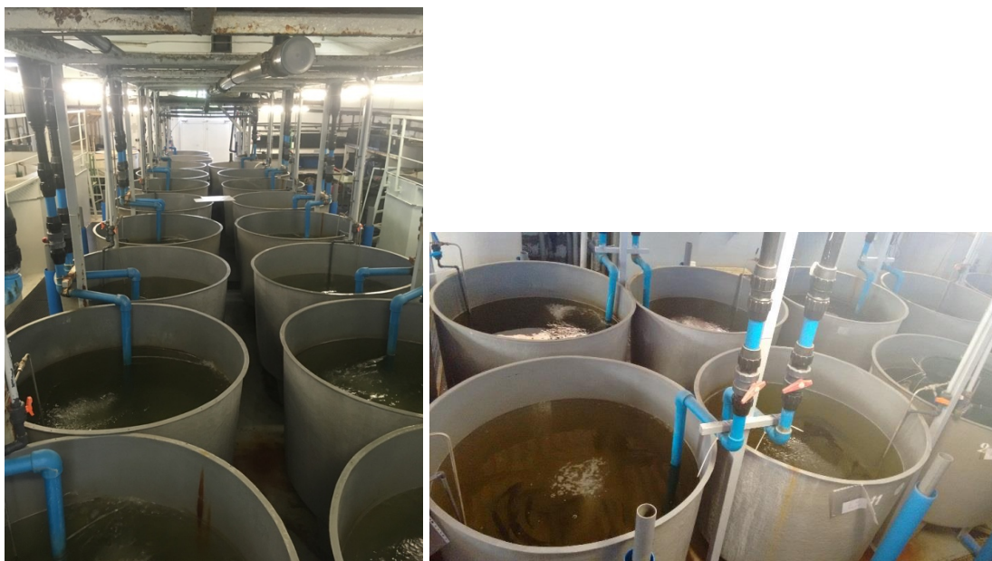
Figura 5: Tanques de la Línea 2 del LAC.
