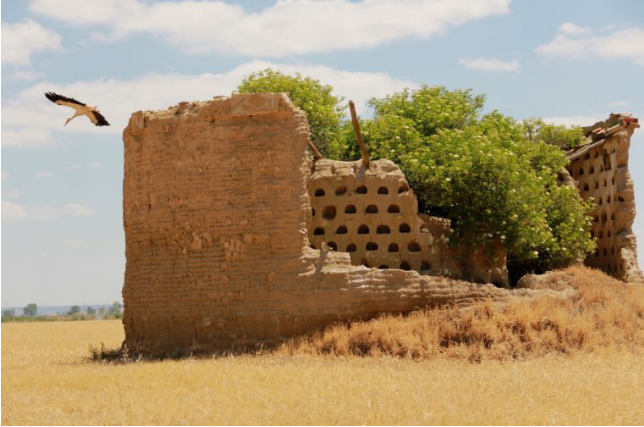
Fig 1.3. Arquitectura tradicional de Palencia: palomar en Mazariegos. La arquitectura popular surge como respuesta a las necesidades y posibilidades de los usuarios y a las exigencias derivadas de la tradición cultural de la zona geográfica en que se produce al igual que sucede con la arquitectura llevada a cabo por los animales
