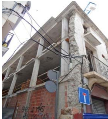
Figura 13: Sustrucción funcional de muro (Lorca)
