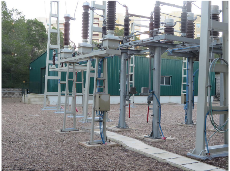
A8.8. Enclavado E10V9, avenida de los pinos 87. Fuente: www1.sedecatastro.gob.es/Cartografia/mapa.aspx . Contenido: subestación eléctrica construida en 1972 para dar servicio a la urbanización de la Devesa .
