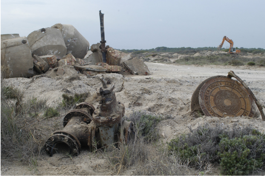
F92. Fotografía de las obras de demolición de pozos y viarios en la Devesa Sur (2003). Proyecto LIFE Duna . Fuente: Archivo fotográfico del Servicio Municipal Devesa-Albufera .
