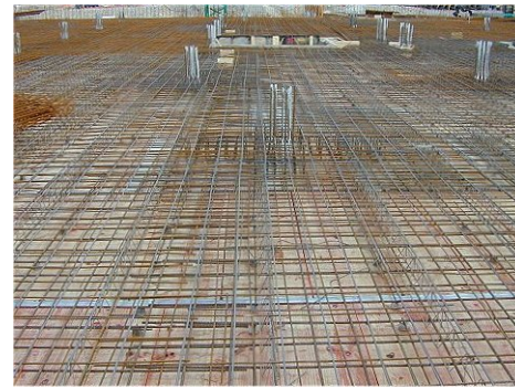
2. Una vez finalizado el encofrado, se disponen las armaduras en el lugar correspondiente.
