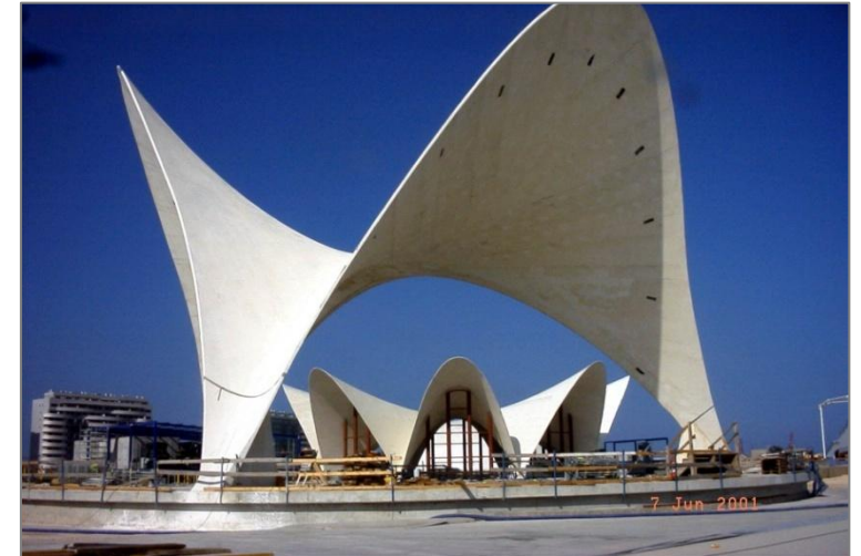
5.25 Estructura auxiliar de cerramiento
