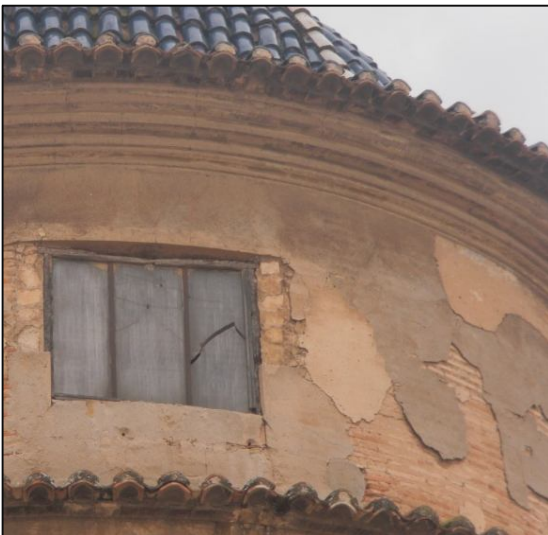
Estado del tambor de la cúpula
