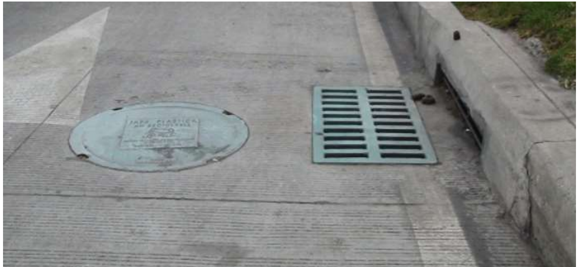
Ilustración 16: Imbornal con tapa plástica de PVC cortesía de Maderplast S.A
