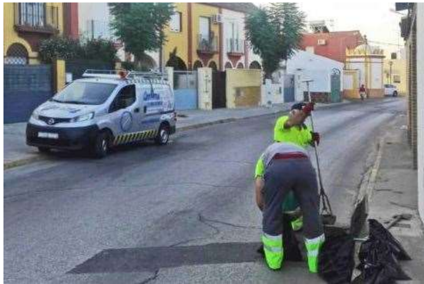
Ilustración 19: Operarios realizando la limpieza del imbornal de forma tradicional. Cortesía de ayuntamiento de Benacazon.
