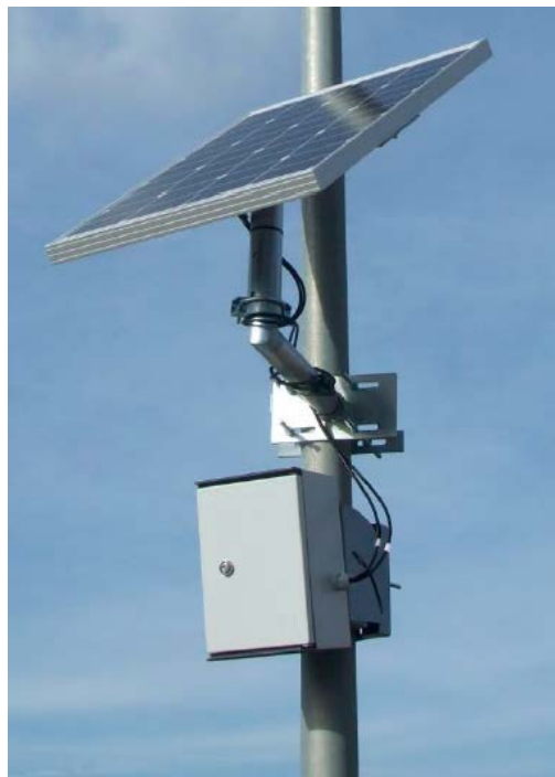
Fig. 11.8 - Sistema de aforo mediante radar no intrusivo
