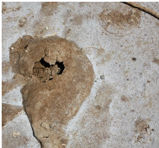
Figura 3: Sales en superficie por ascenso capilar
