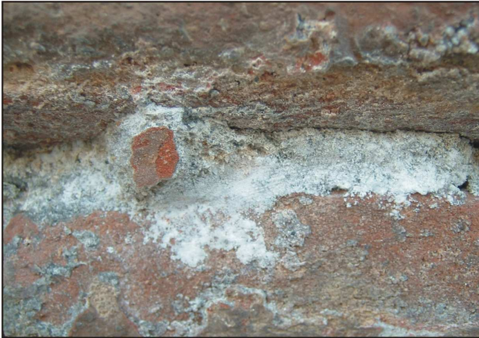
Fig. 8. Detalle de eflorescencias salinas en zona de pérdida de película pictórica.
