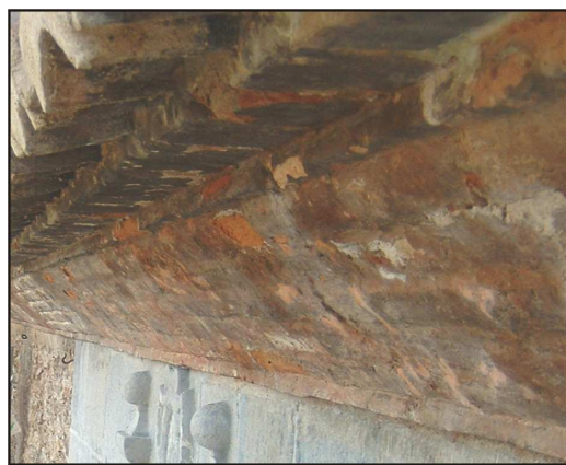
Fig. 5. Fotografía de la cornisa inferior donde se observan lagunas y suciedad por toda la superficie pictórica.
