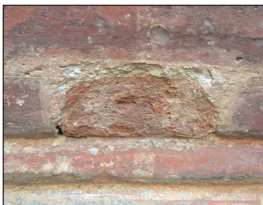
Fig. 6. Pérdida volumétrica de ladrillo y pérdida de película pictórica.
