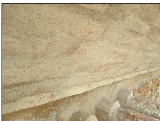
Fig. 10. Cornisa superior antes de la intervención.
