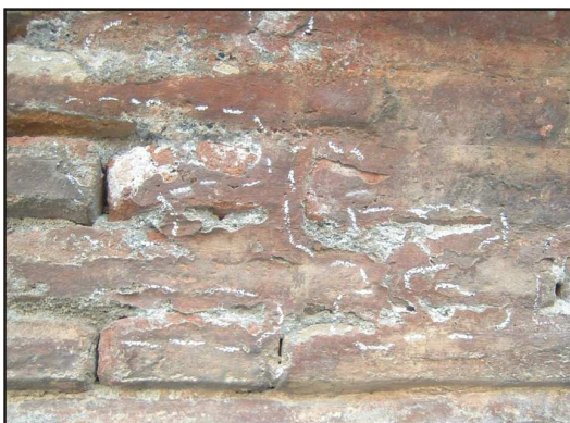
Fig. 16. Delimitación de zonas con eflorescencias salinas.
