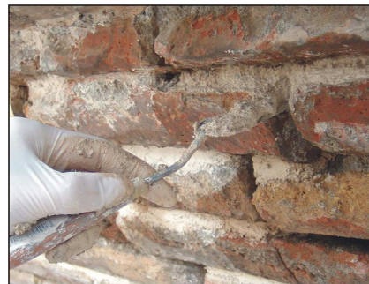
Fig.27 Detalle de la aplicación del mortero en las juntas de los ladrillos.
