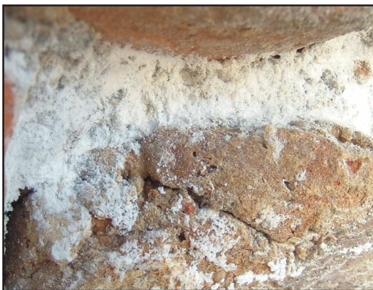
Fig. 14. Detalle de eflorescencias salinas.
