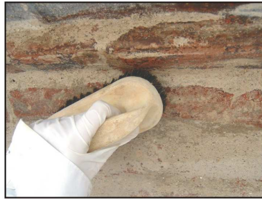
Fig. 42. Limpieza de polvo superficial con cepillo suave, después de la utilización del chorro de arena.
