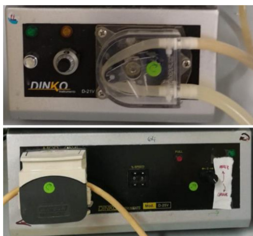
Figura 45. Bombas de llenado de los SBR de DINKO Instruments.
