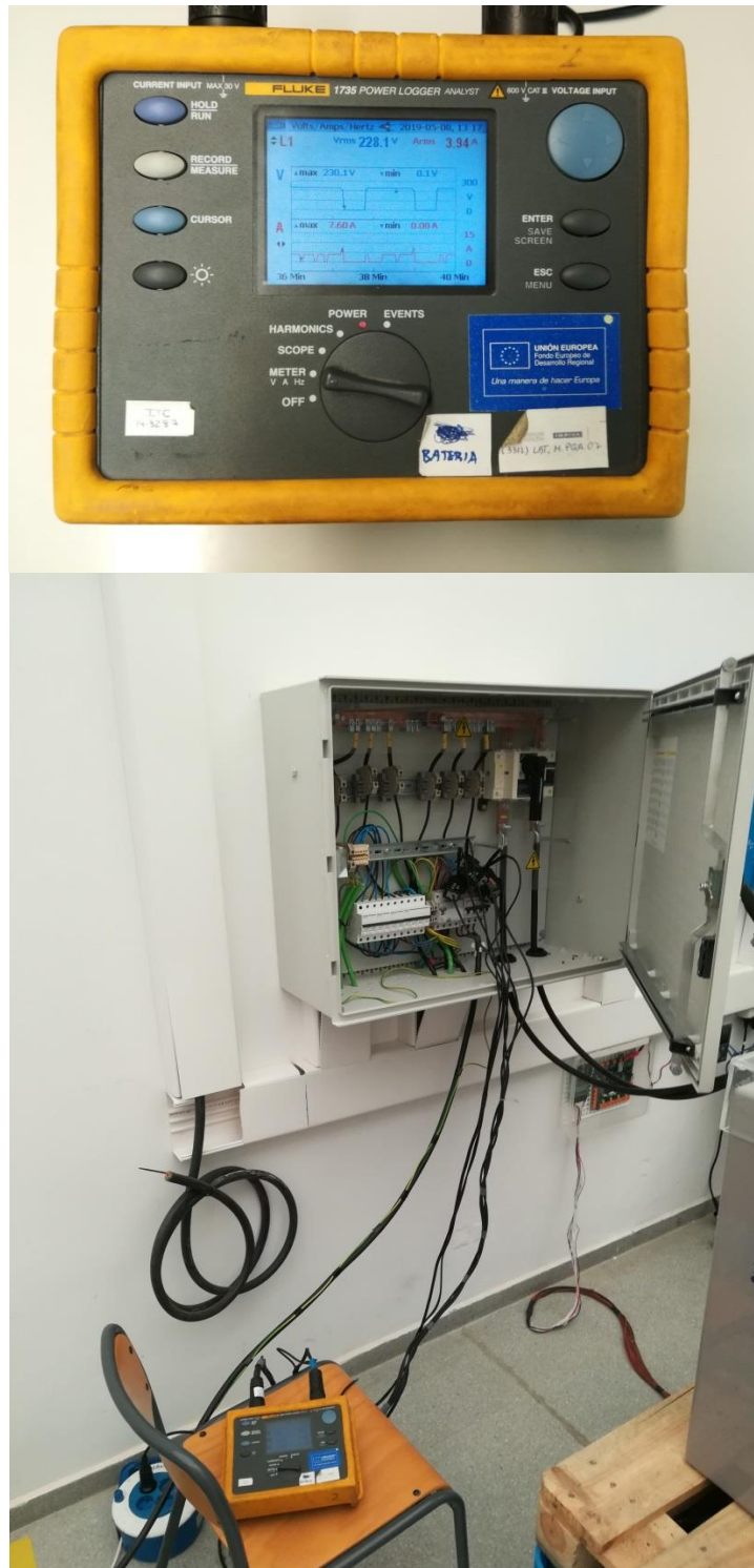
Fig. 31. Analizador de red en la instalación de laboratorio
