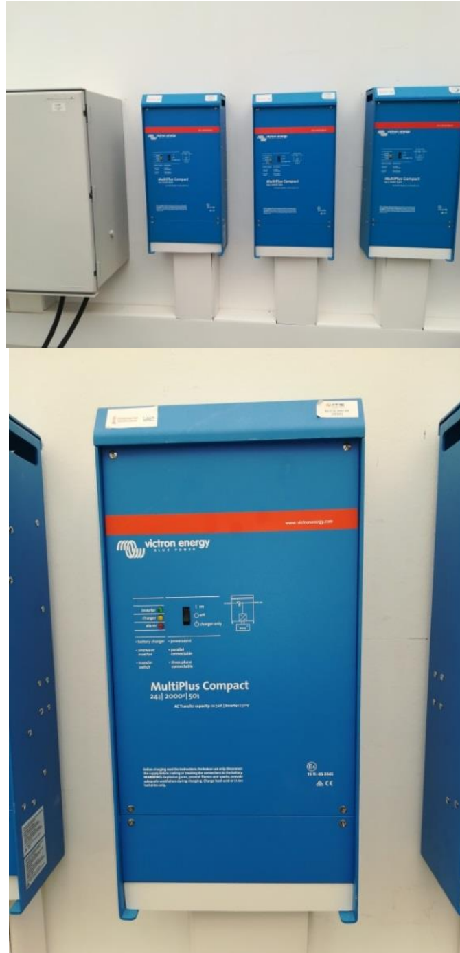
Fig. 28. Inversores de la instalación de laboratorio
