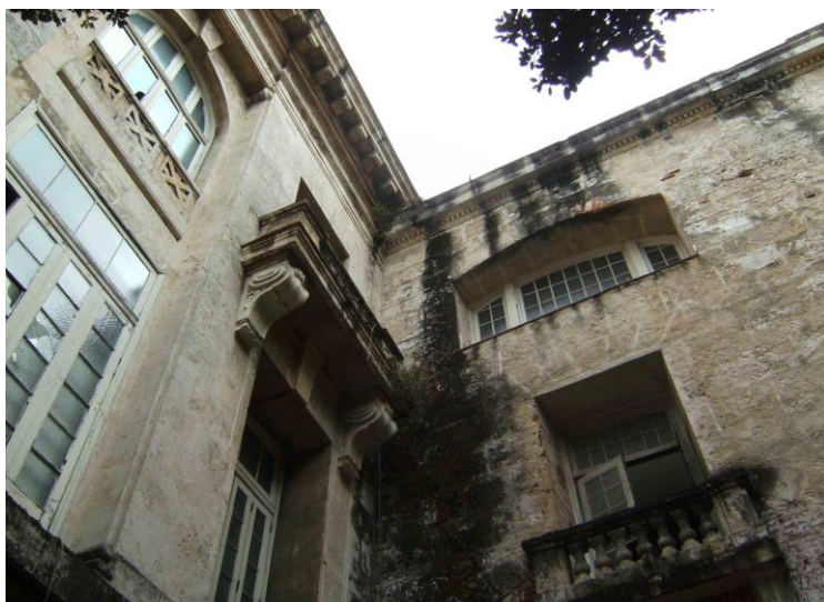
Lesiones en muros de sillares de piedra caliza conchífera en el antiguo edificio de la Cámara de Representantes Fuente: Autor.
