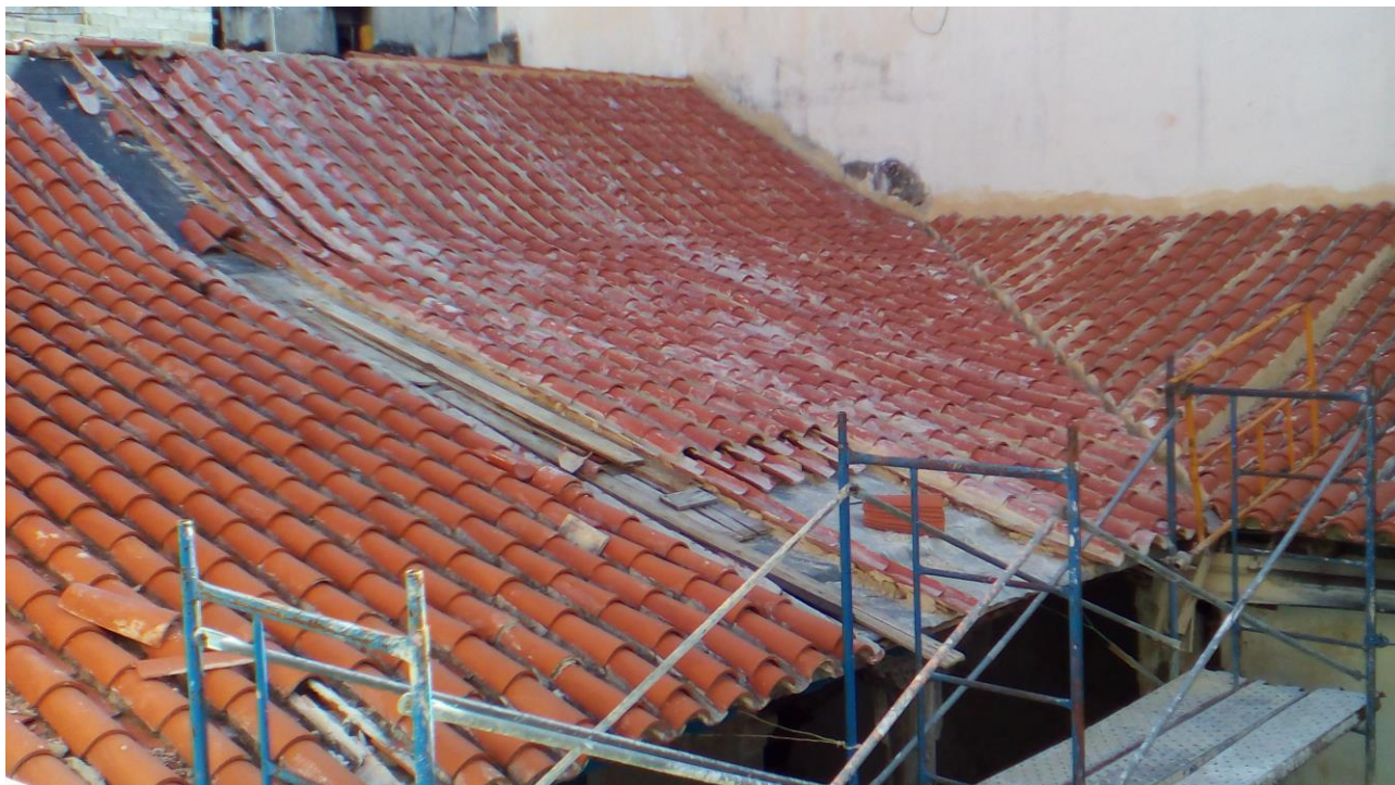
Estado actual de algunas de las cubiertas. Casa Prat Puig, 2016.
