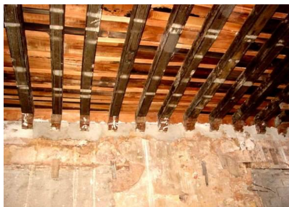
Secuencia de restauración de cubierta plana de viga y tablazón_ La Habana Vieja (s/i)
