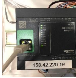
Ilustración 15. Conexión del PLC mediante cable Ethernet.
