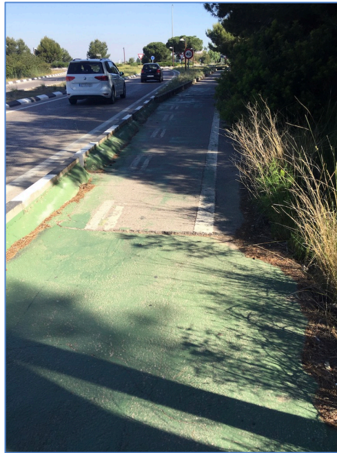
Figura 134. Estado carril bici 1.
