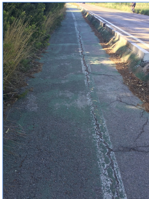
Figura 135. Estado carril bici 2.
