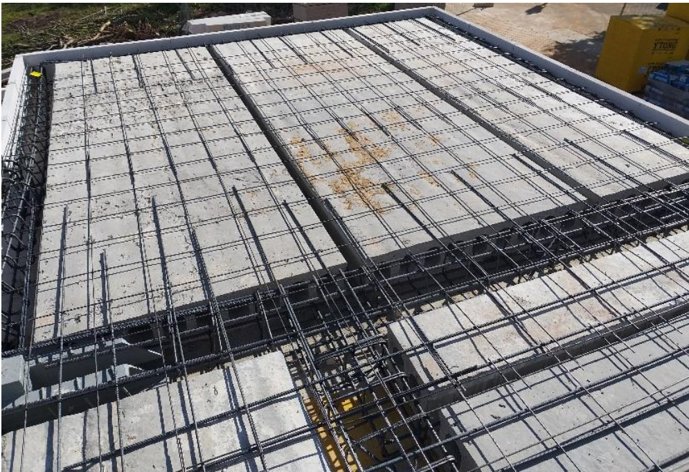
Figura 47. Armado completo de una parte del forjado de la planta baja. Fuente: elaboración propia.
