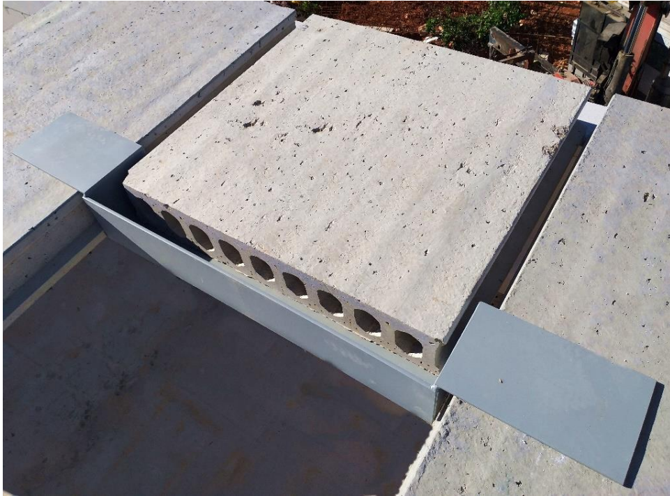
Figura 42. Apoyo de una placa alveolar en chapa metálica y muro de bloques de hormigón celular. Fuente: elaboración propia.
