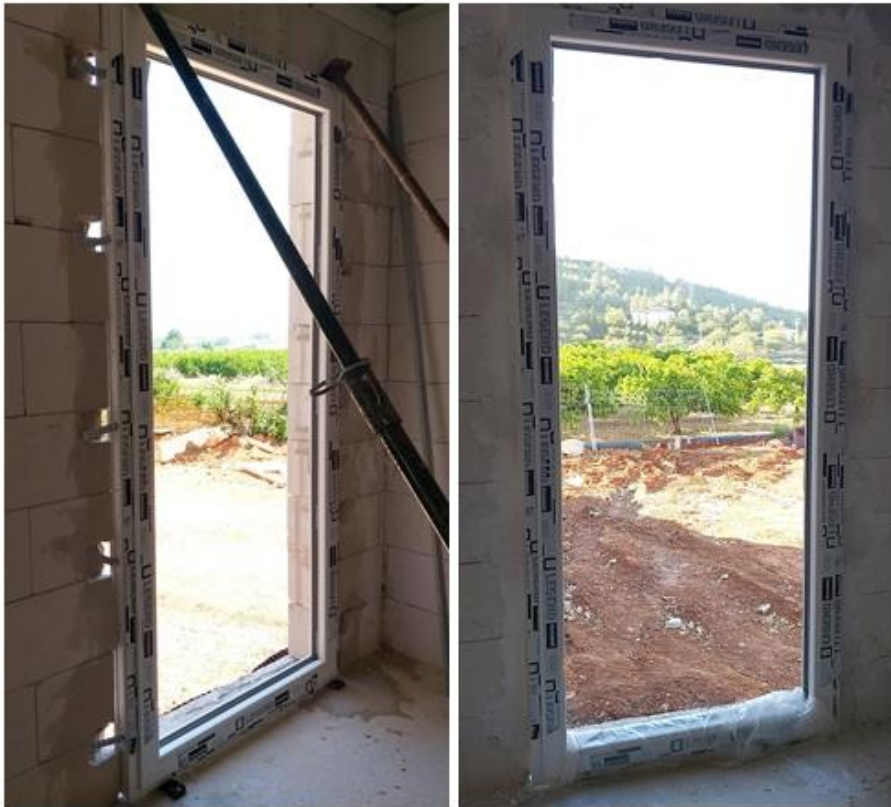
Figura 72. Colocación de ventana donde se observan las garras en el proceso de nivelación y seguidamente, el falcado al muro mediante yeso. Fuente: elaboración propia.
