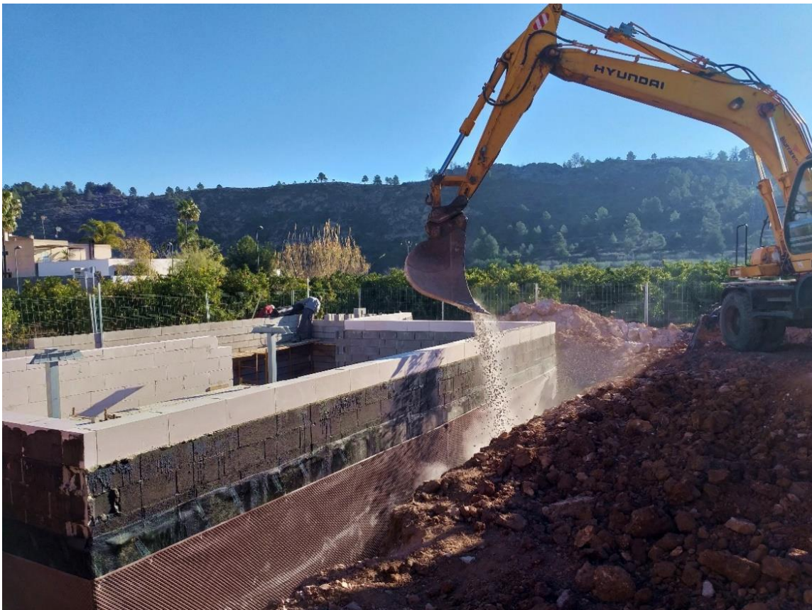
Figura 58. Vertido de gravas en el trasdós del muro de sótano mediante pala cargadora. Fuente: elaboración propia.
