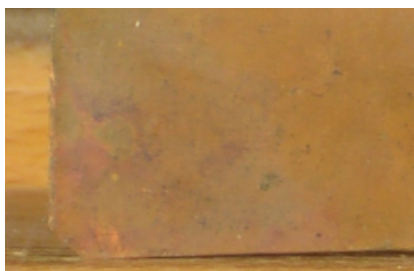
Fig. 44 Detalle de corrosión.
