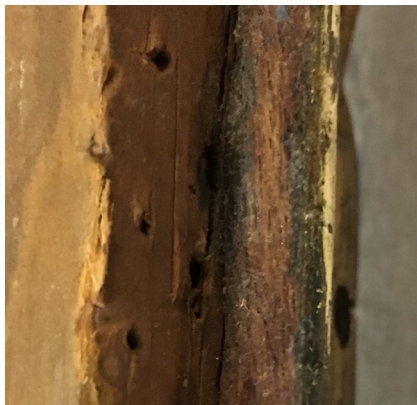
Fig. 50 Marcas de corrosión en la madera y orificios en el marco
