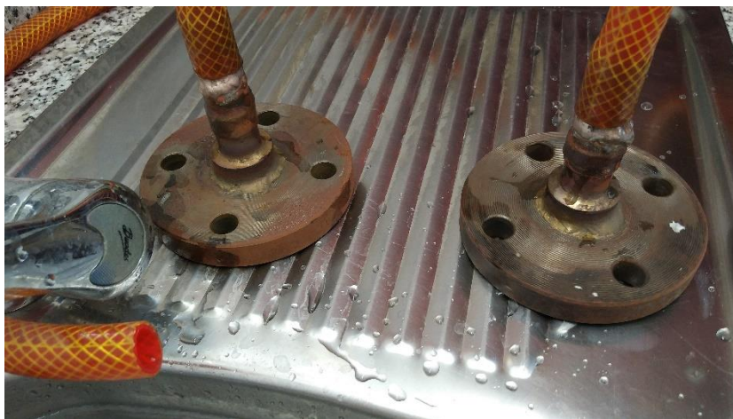
Ilustración 15: Bridas para la conexión del caudalímetro.
