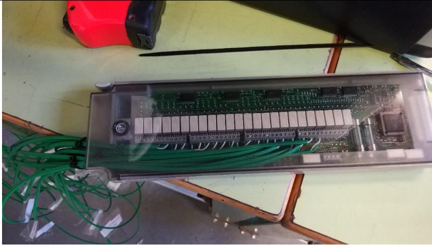
Ilustración 9: Conexión de los termopares a la tarjeta de adquisición de datos.
