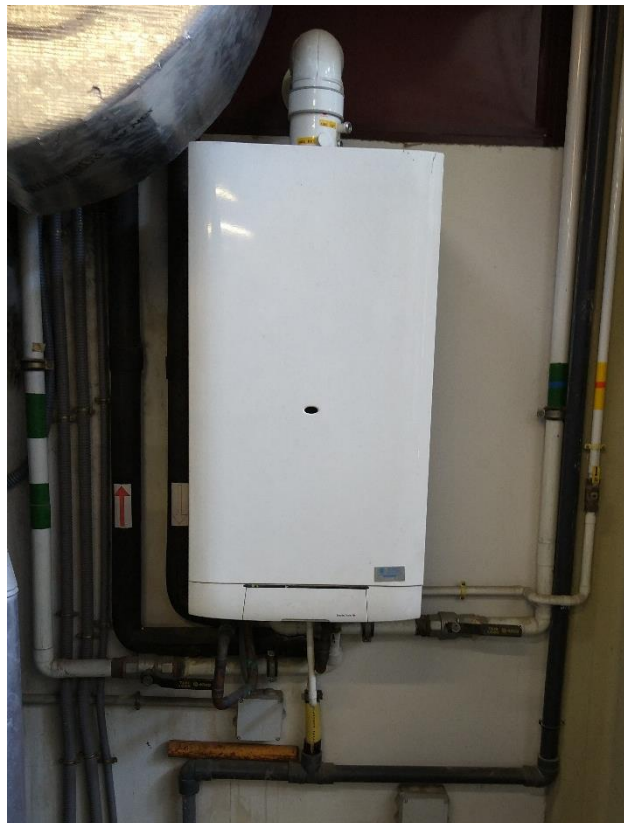
Ilustración 2: Caldera ISOFAST F 28E en la instalación.
