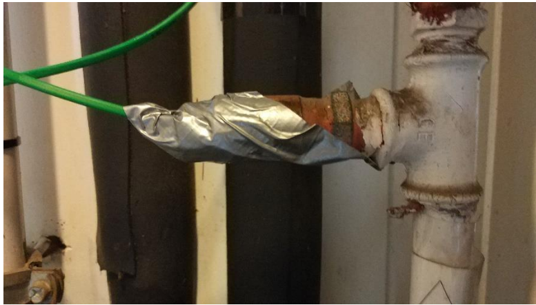
Ilustración 8: Instalación de termopares en la impulsión y el retorno del agua.
