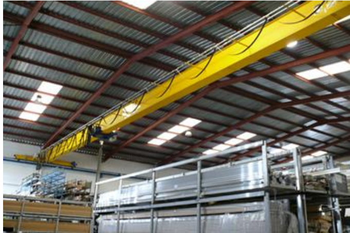
Figura 31. Puente grúa en la zona del almacén.
