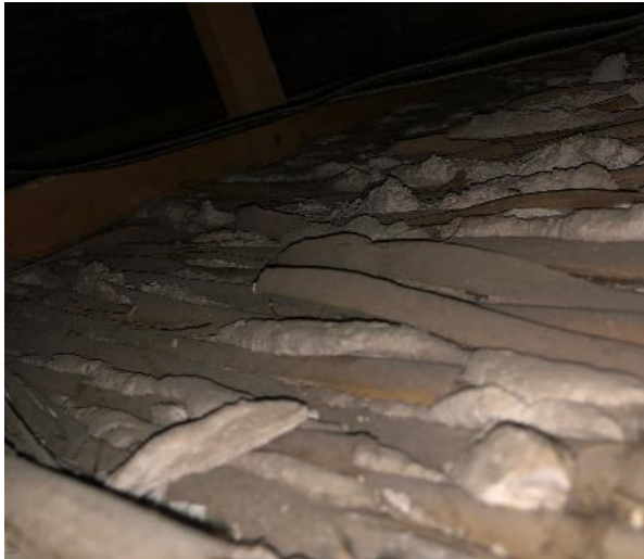
Imagen 46. Falso Techo Dormitorio 3. Fuente Propia.
