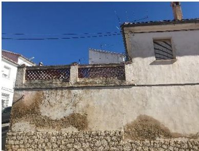
Imagen 71. Lesiones en Fachada Lateral. Fuente Propia.
