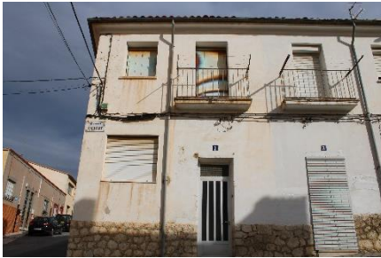
Imagen 73. Lesiones en Fachada Principal. Fuente Propia.
