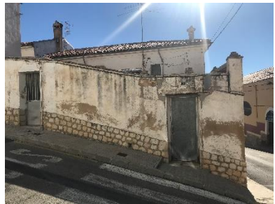
Imagen 72. Lesiones Muro Posterior. Fuente Propia.
