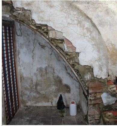
Imagen 75. Lesión Escalera Exterior. Fuente Propia.
