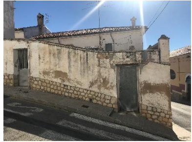
Imagen 74. Lesiones Muro Posterior. Fuente Propia.
