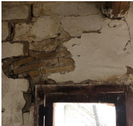
Imagen 42. Dintel Ventana Cobertizo. Fuente Propia.
