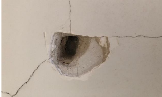
Imagen 44. Cata Dintel Puerta Dormitorio. Fuente Propia.
