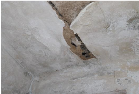
Imagen 69. Lesión Forjado Planta Primera. Fuente Propia.
