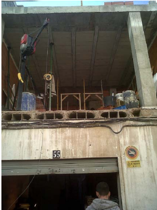
1.1 Vista de la fachada principal de la obra el primer día de visita
