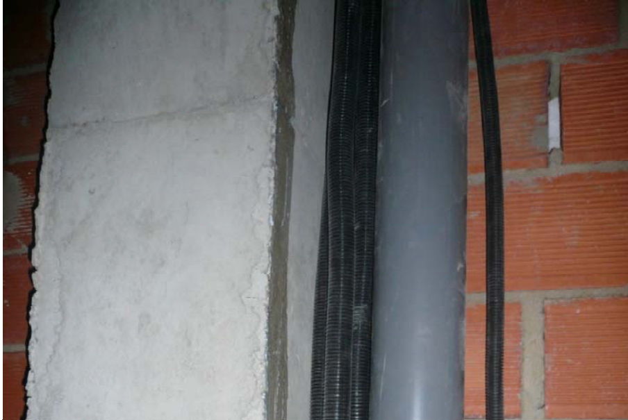
3.10 Conflicto entre saneamiento y electricidad.
