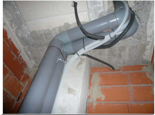
3.8 Conflicto entre saneamiento y electricidad.
