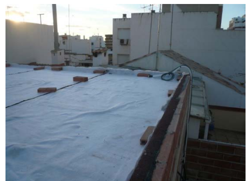
5.2 Estado actual de las cubiertas. cubiertas.
