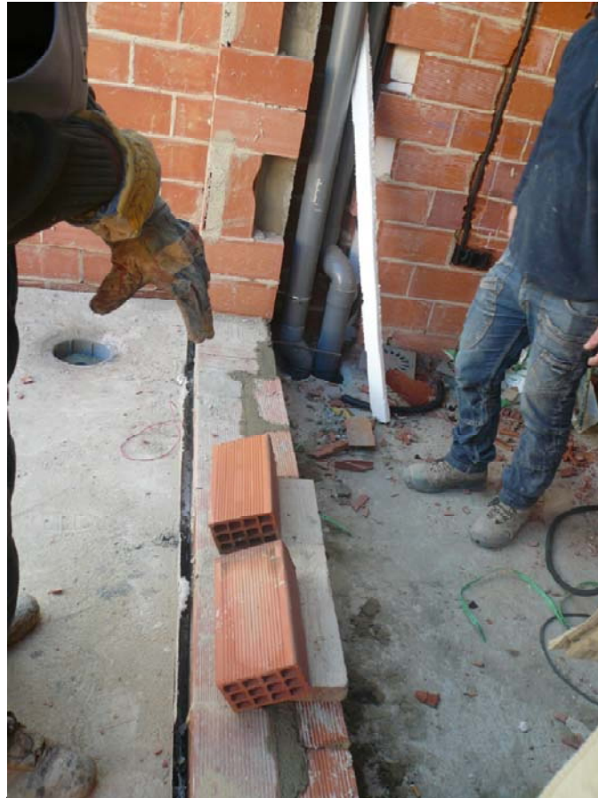
4.4 Detalle sumidero separado 50 cm del paramento vertical.
