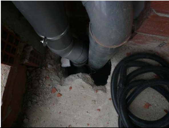
3.7 Conflicto entre saneamiento y electricidad.
