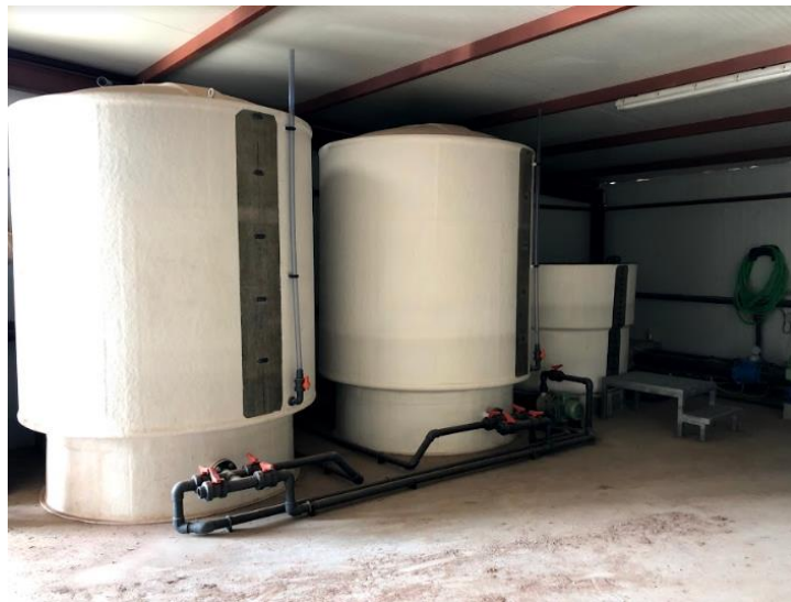
Figura 4. Tres depósitos instalados, dos de almacenamiento y uno con agitador
