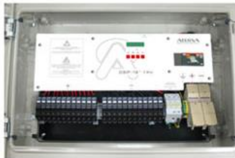
Figura 19. Caja de conexión CSP-12TM 1kV
