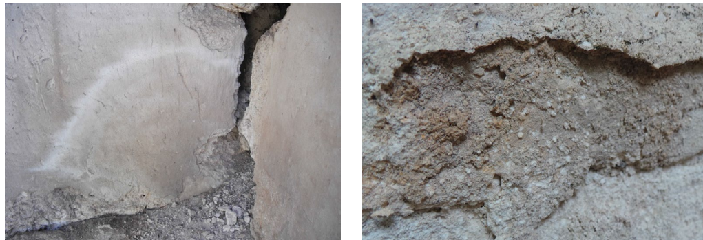
Fig.4.32 Evaporación de humedad con aparición de eflorescencias sobre el estuco de la esquina suroeste de 6J2-18, que presenta abertura y separación de ambos muros por carga estructural. Fig.4.33 Sub-eflorescencias entre estratos del estuco que han provocado la desintegración y desprendimiento de la primera capa.
