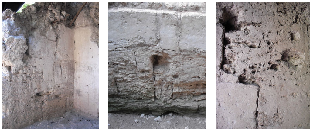
Fig. 4.34 Degradación de la piedra caliza con marcada erosión, que ha provocado el desprendimiento del estuco. Fig. 4.35 Estratificación diferencial de los sillares en las franjas bajas de los muros. Fig. 4.36 Principio de alveolización del material pétreo que se va abriendo paso hacia la superficie estucada.
