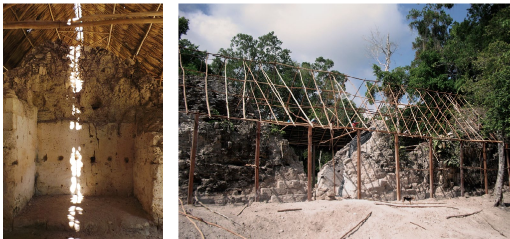
Fig. 6.7 Cubierta de guano con grave deterioro en el vértice superior por donde a demás de la lluvia, se filtran las radiaciones solares. Fig.6.8 Proceso de realización de la gran cubierta del ala oeste de la Acrópolis tras su excavación en 2009.
