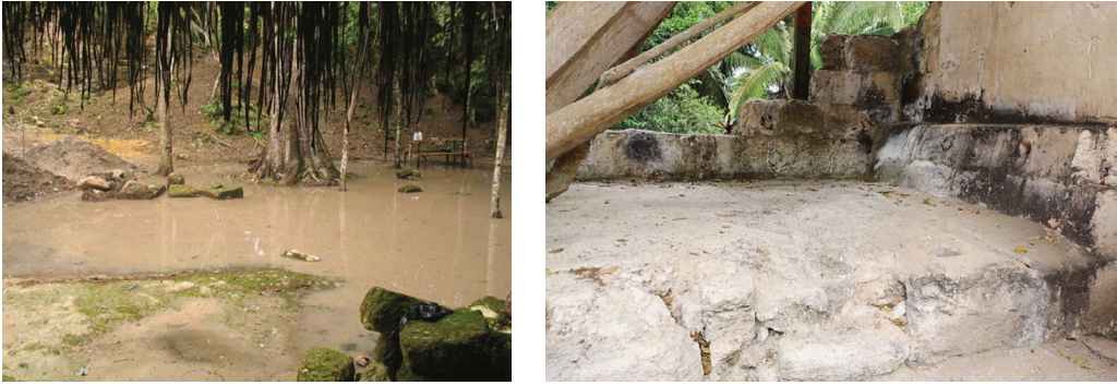
Fig. 6.5 Vista desde 6J1-3, 2008. Encharcamientos en la plaza de la Acrópolis debido a los desniveles existentes en la misma. Fig. 6.6 Cuarto 6J1-5. Entrada excesiva de agua en la estancia debido a la falta de gran parte del muro este (fondo) y a la poca proyección de la cubierta por este lado.
