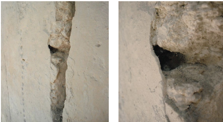
Fig. 4.30 Cuarto 6J2-6; detalle de zona del paramento donde se ha perdido el soporte pétreo y el estuco sigue firme.
