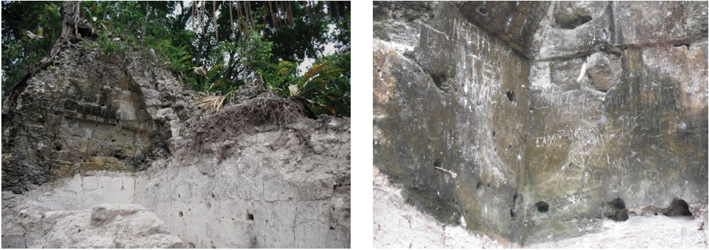
Fig. 4.18 Colonización de macro y micro flora sobre las ruinas en la zona expuesta a la intemperie. En la zona que quedó bajo sepultura se observan grietas, fracturas y desprendimiento del estuco. Fig. 4.19 Detalle de zona de la bóveda que quedó expuesta y que ha sido atacada por microorganismos y por acciones antrópicas.
