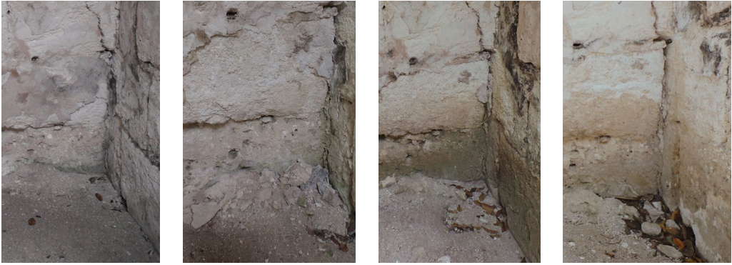
Fig. 4.28 Secuencia: Esquina suroeste del cuarto 6J1-5 en 2013, 2015, 2016 y 2018. Debido a la exposición de este cuarto, es continua la acumulación de agua de lluvia y la radiación solar en esta zona. Se aprecia como el poco estuco presente en 2013 comienza a desprenderse a pesar de los refuerzos, habiendo desaparecido para el último año, mostrando un avanzado estado de pulverulencia el soporte pétreo.
