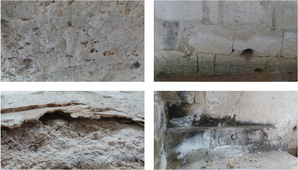
Fig. 4.20 Escamación y pulverulencia progresiva del estuco. Fig. 4.21 Eflorescencias en forma de velos blanquecinos tras la excavación del cuarto. Fig. 4.22 Separación del estuco del soporte por pulverulencia de la piedra caliza. Fig. 4.23 Aparición de fuertes concreciones biológicas y eflorescencias por entrada de agua en el cuarto 6J1-5.
