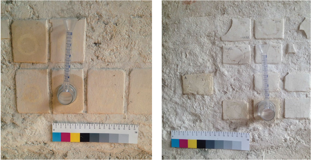
Fig. 5.61 y 5.62 Ensayos de penetración de agua realizados en 2017 sobre las probetas conservadas. Foto B. Carrascosa.
