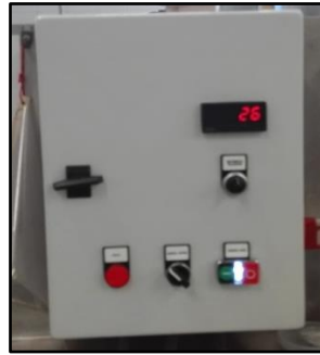
Figura 14. Detalle del cuadro de mandos de la planta de nanofiltración.
