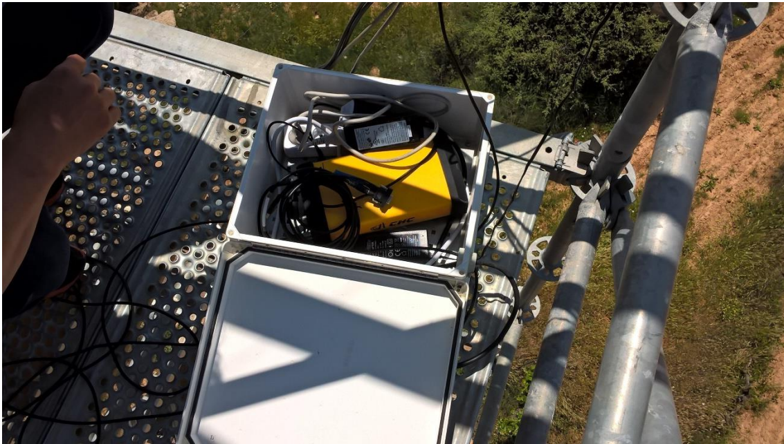
Ilustración 30, Caja metálica de protección.
