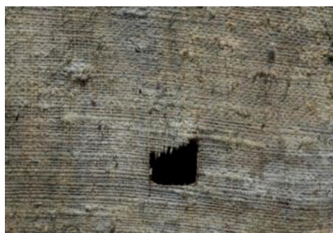
Figura 23. Fotografía de detalle del faltante.
