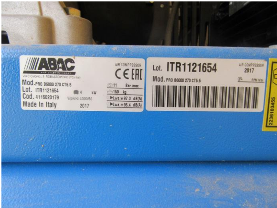
Fotografía 34. Compresor aire trabajos y placa de características.
