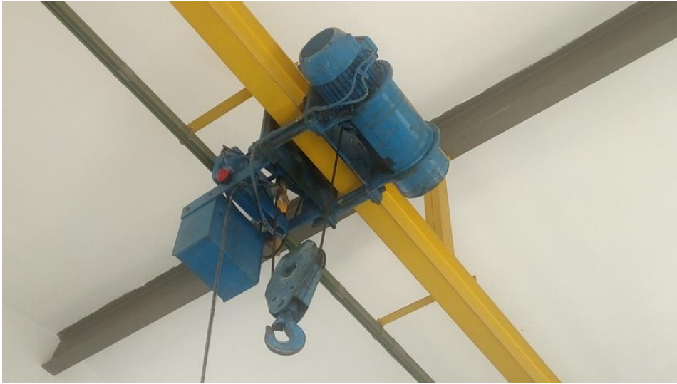
Fotografía 30. Puente grúa taller calderería.
