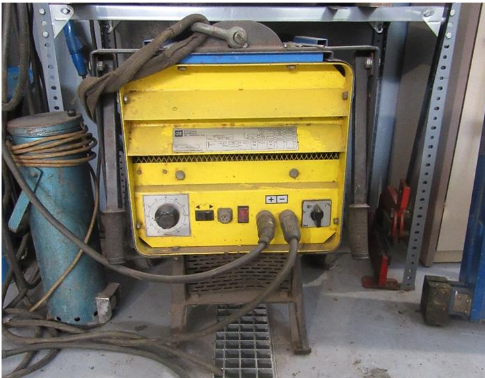
Fotografía 31. Equipo soldadura trifásico taller calderería.
