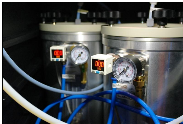
Fig. 32. Monitorización presión tanques de adhesivo
