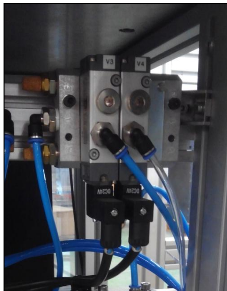
Fig. 62: Válvulas de accionamiento
