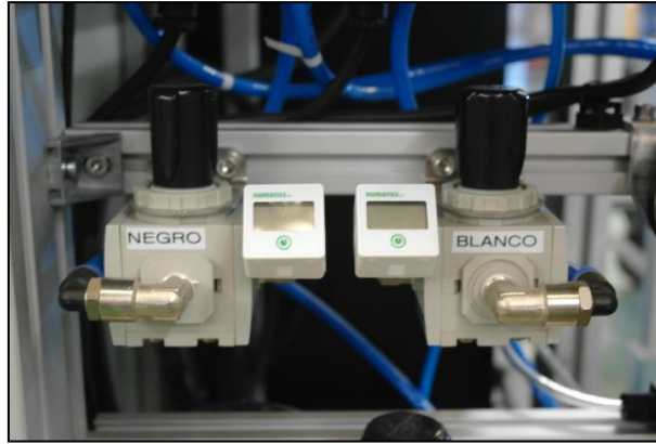
Fig. 31. Control presión tanques de adhesivo
