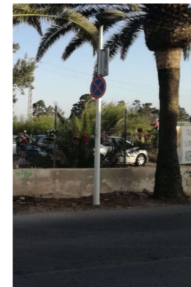
Ilustración 34. Red de alumbrado público. Fuente: Elaboración propia.
