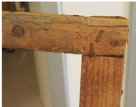
Fig. 7. Presencia de oxidación de clavos en el ángulo del bastidor.
