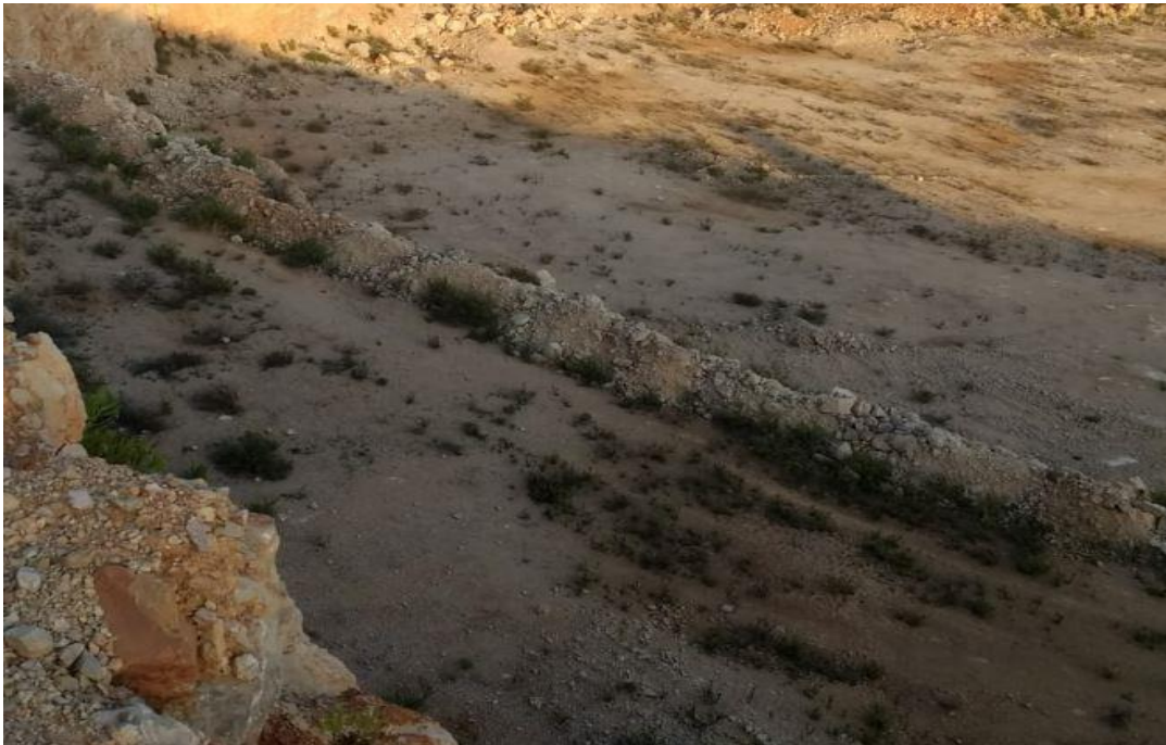
Figura 27. Muro de contención, situado en la cota más baja de la banqueta.
