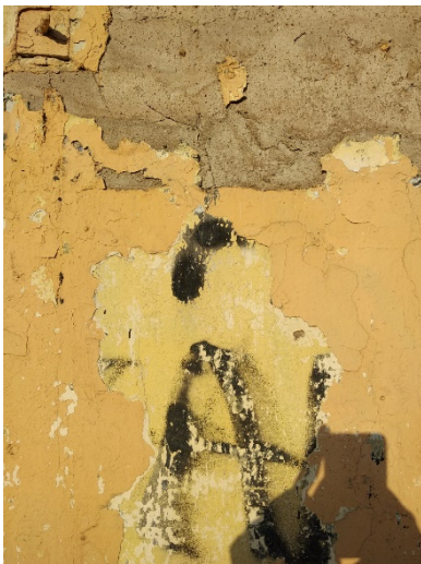
Fig.17 Detalle de un muro en el barrio del Cabañal, Valencia (fotografía propia) 2019.
