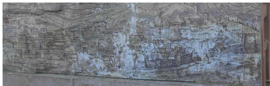
Fig. 41. Zona del mural con presencia de eflorescencias salinas.
