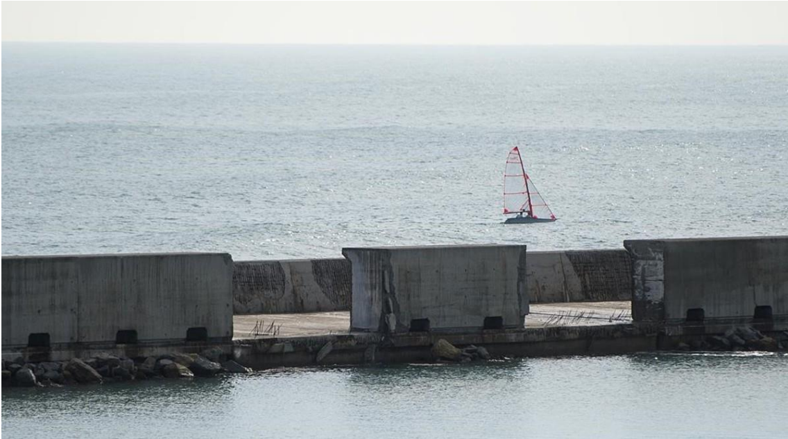
Figura 3. Rotura de sendos tramos del espaldón interior del dique de abrigo. Fuente: elPeriódico.
