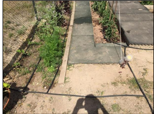
Figura 81. Conexiones a sectores 2 y 5.
