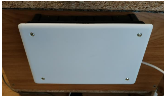
Figura 27. Caja de registro
