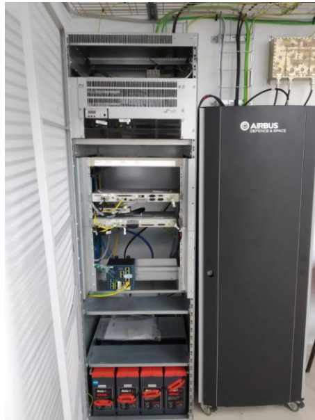
Ilustración 1. Instalación real de EB en un Ayuntamiento
