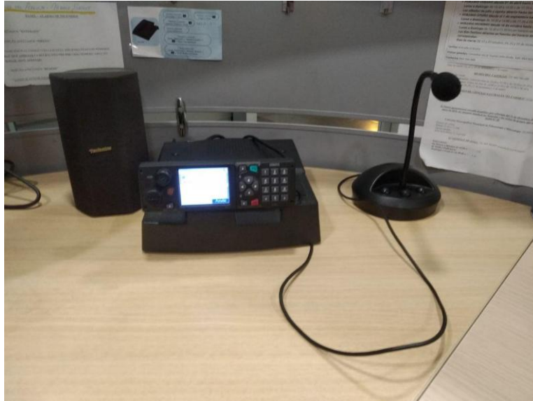
Ilustración 2. Instalación real de terminal fijo en Central de Policía Local
